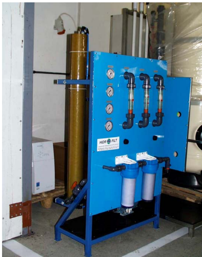
16. ábra A félüzemi arzénszűrő berendezés
